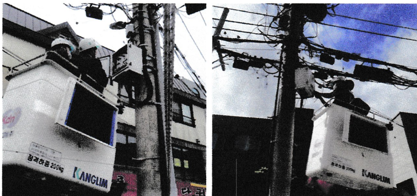
DCU 및 전력량계 현장 설치 모습
